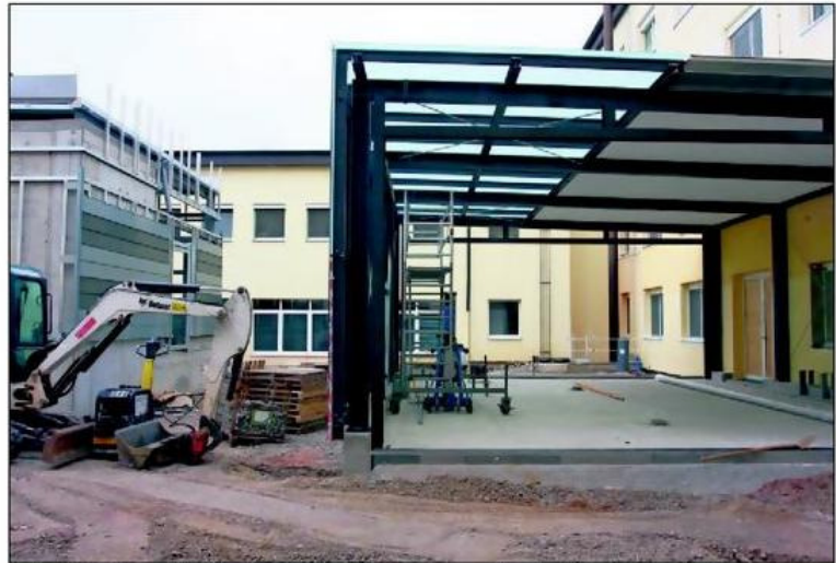
Im Innenhof des Kreiskrankenhauses wird gebaut. Rechts entsteht die gläserne Halle, die künftige Zufahrt für Rettungswagen, links ist der Rohbau des neuen Wirtschaftsgebäudes. FOTO: BENNDORF
